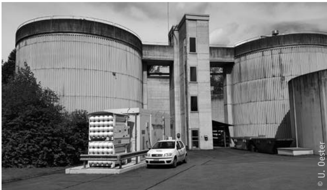
Treibstoff aus Klärgas: in Schönenwerd wird Biogas zu Erdgasqualität aufbereitet. Im Hintergrund die Faultürme, im Vordergrund die Anlage mit Technikcontainer und Speicherbündeln.
