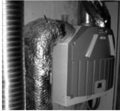
Im Keller steht die Lunge des «Kontrollierten Lüftungssystems»: Mittels Wärmetauscher erwärmt die warme Raumluft die frisch angesogene Aussenluft.
